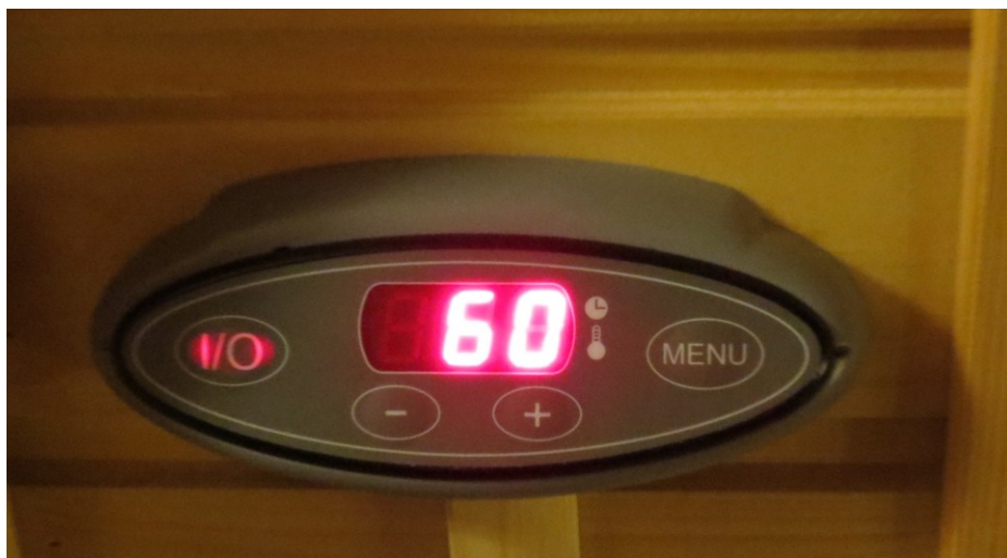
Kuva 7.3.2 Kiukaan elektronisesta ohjauspaneelistä voi antaa saunan lämpötilalle asetusarvon. Esimerkiksi 60 °C voisi olla sopiva lämpötila energiansäästäjälle.
