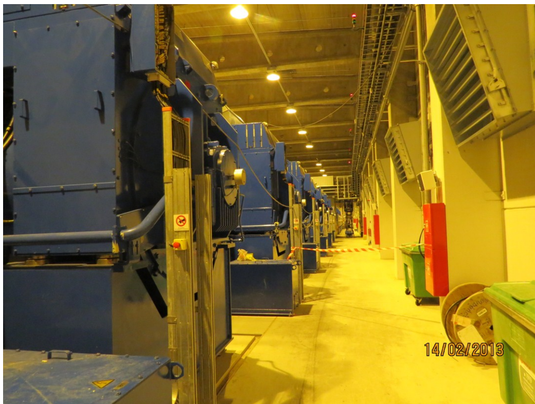
Kuva 2.3.2 Tallinnassa on rakenteilla Eleringin 250 MW:n tehoinen varavoimala, jossa on 25 Wärtsilän 10 MW:n tehoista Vaasassa tehtyä kaasuoiljymoottoria.
